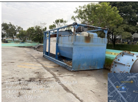
Fotografía No. 9. Vista lateral motobomba sobre estructura endurecida previamente.
