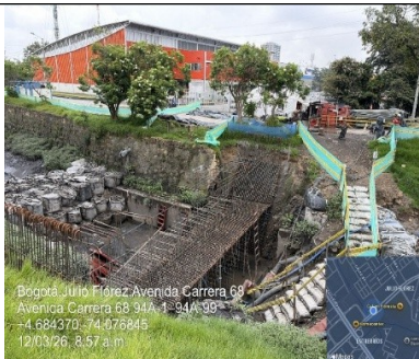
Fotografía No. 3. Vista superior Estructura de control y bolsacreto aguas abajo.
